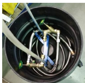
Wnętrze studzienki z wężami w oplocie ze stali nierdzewnej.
