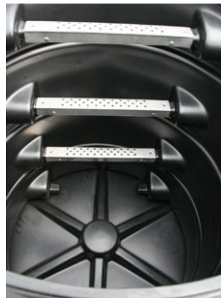
Wnętrze studzienki wyposażone w stopnie ze stali nierdzewnej
