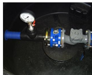
Zdj. nr 2. Przykład zabudowy armatury
